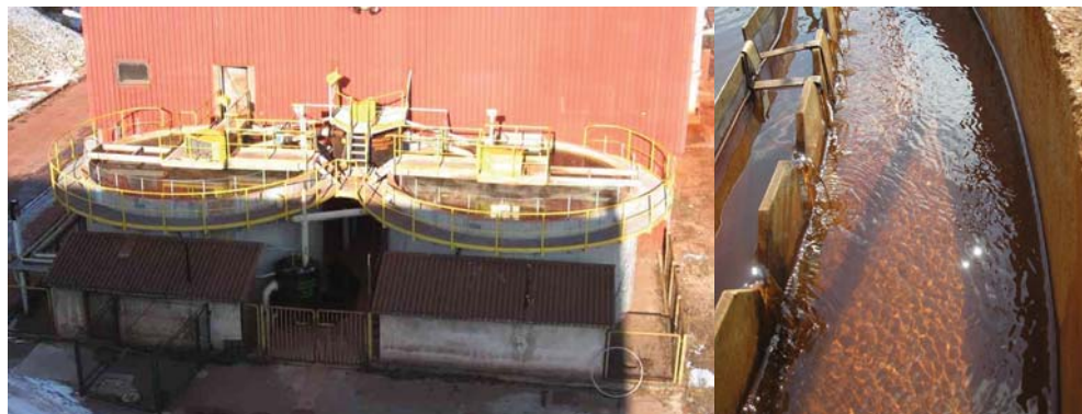
Slika 4: Sodelovanje med IJS in ESOTECH-om: rekonstruirana industrijska čistilna naprava za odpadno vodo v železarni ACRONI, Jesenice (levo), iztok očiščene odpadne vode (desno)
